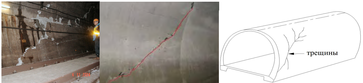
Рисунок 1.6 Вид повреждения - наклонные трещины
