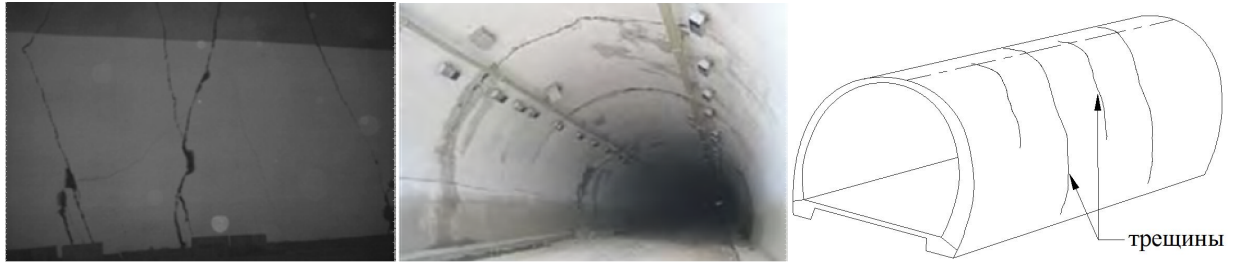
Рисунок 1.5 Вид повреждений - поперечные трещины
