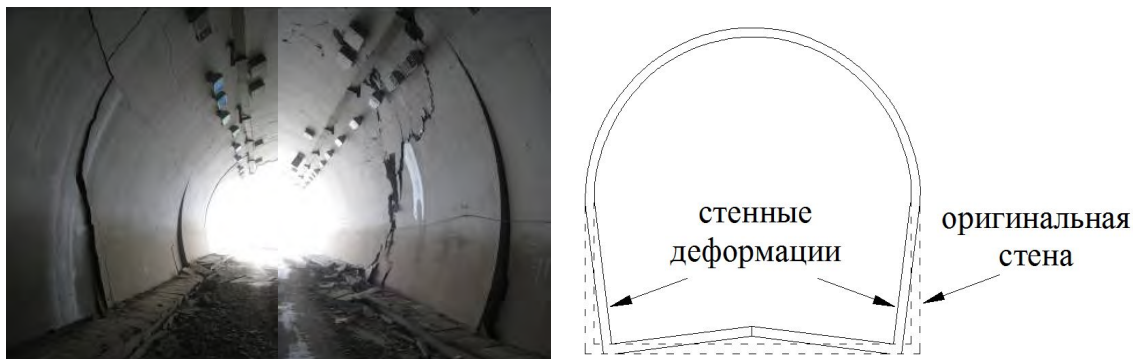
Рисунок 1.8 Вид повреждения – деформация стен
