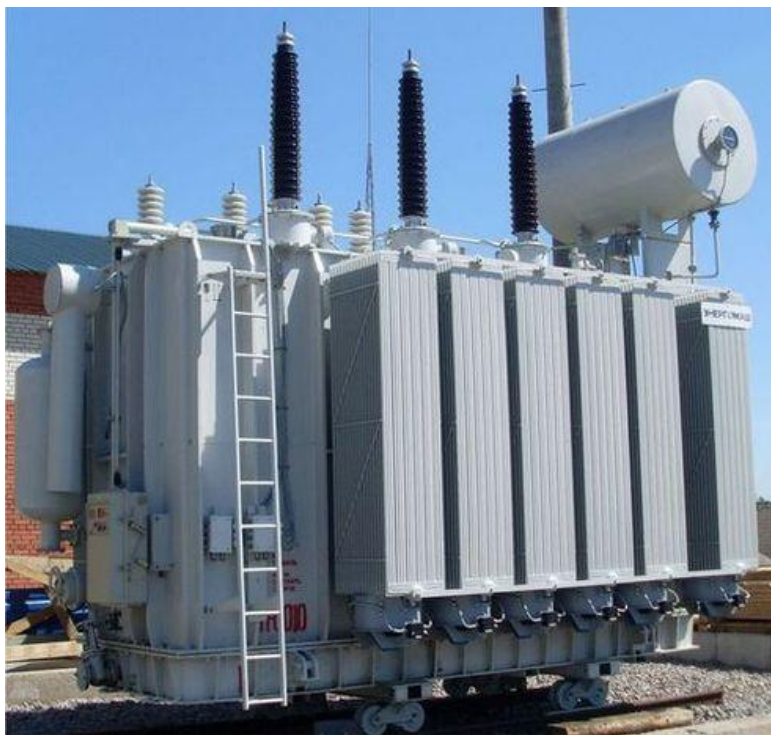
Трёхфазный трансформатор с масляной изоляцией 110/35/27,5 кВ
