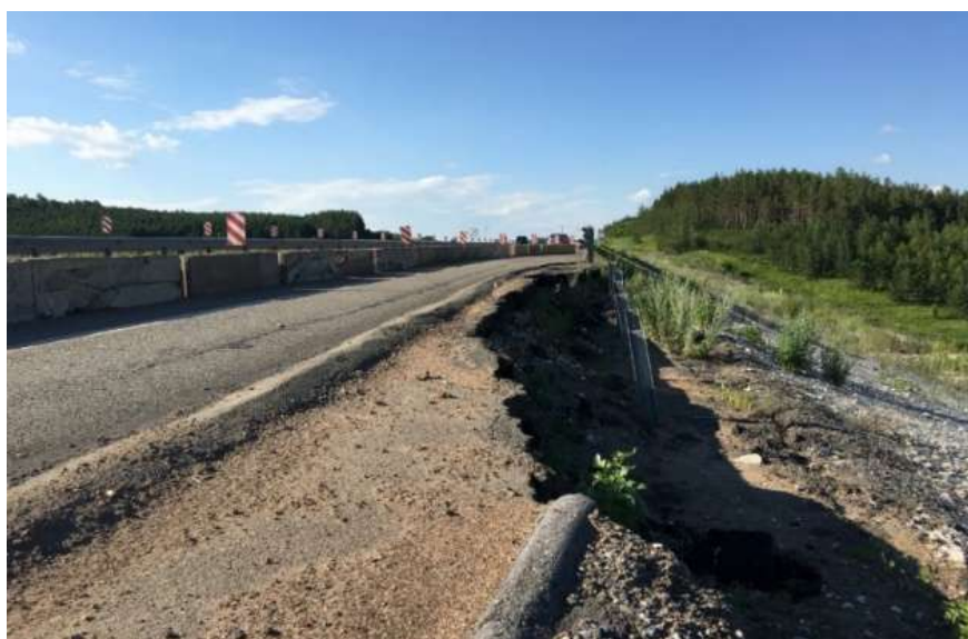
Рисунок 3.15 - Обрушение насыпи на автомобильной дороге Р–240 Уфа – Оренбург км 72
